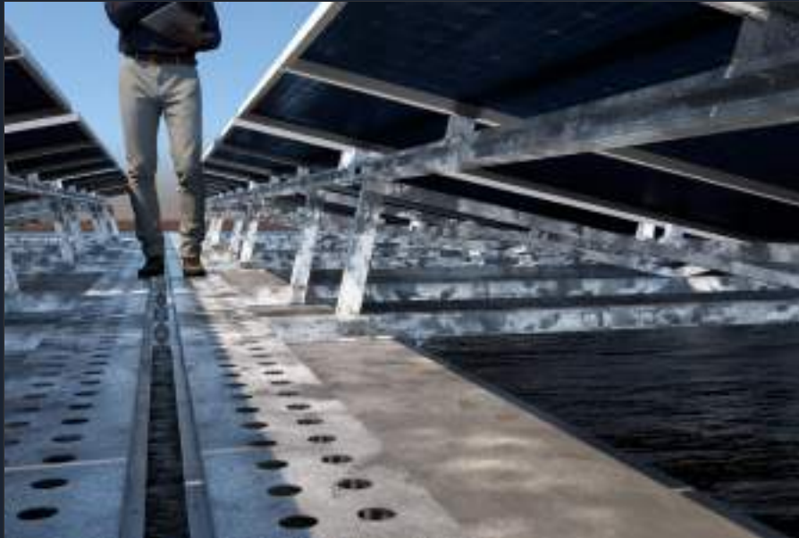
Superficie riflettente in acciaio alluminizzato sotto i moduli bifacciali.
